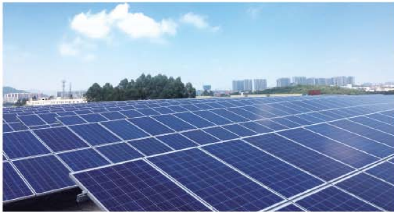
项目名称：中国首个获得德国TUV认证的分布式光伏电站项目——广州易玛1MW光伏电站项目 并网时间：2014年
